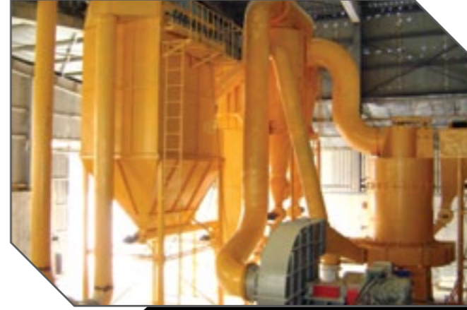
Bentonit Öğütme Tesisi Bentonite Grinding Plant
