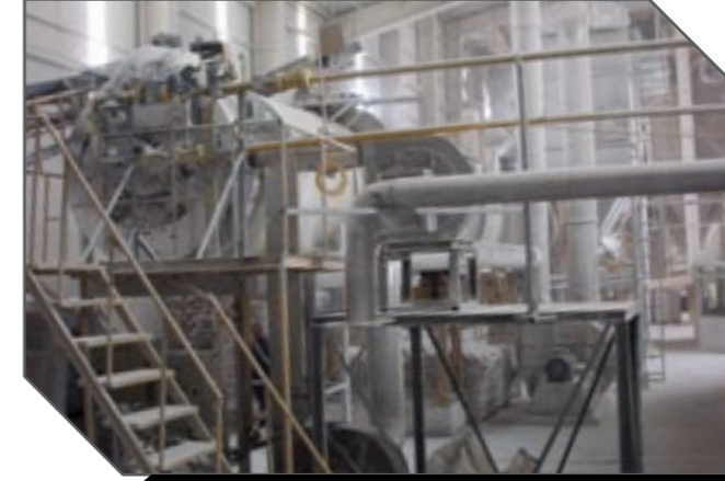
Toz Alçı Tesisi Döner Fırın ve Yanma Odası Powder Gypsum Plant Rotary Kiln and Combustion Chamber
